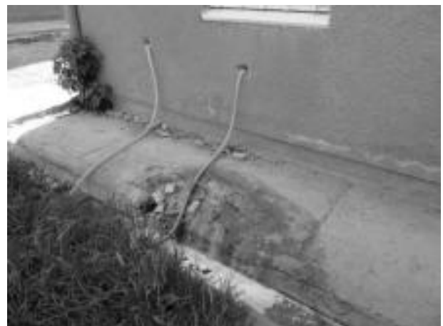
Abb. 8: Abwasser eines Friseurladens in die Regenwasserdrainage, Bole Gerji V, Sept. 2009
